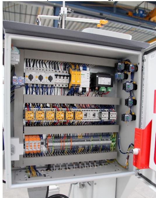
Innenansicht Schaltschrank, mit Freifahr- Schlüsselschalter. Service freundliche Elektrik ohne SPS ! (Standard Ausstattung)
