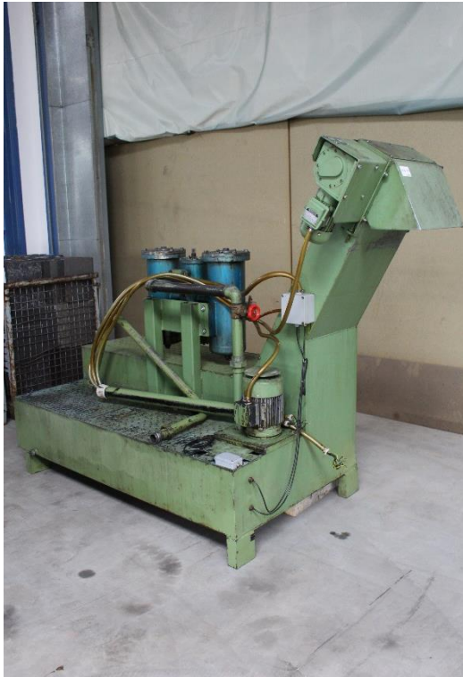
Kühlmittelanlage mit Späneförderer & Feinfilter
